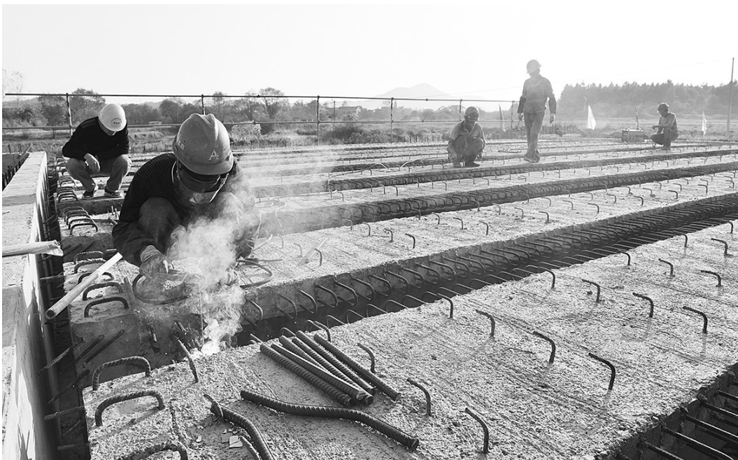
省道360腊树段改建工程施工方抢抓天气晴好时机,多工种同时施工,在保证质量的前提下加快工程进度。图为工人正在进行桥梁湿接缝施工,预计在年底完成路面施工。 张海燕 汪传宝 摄
