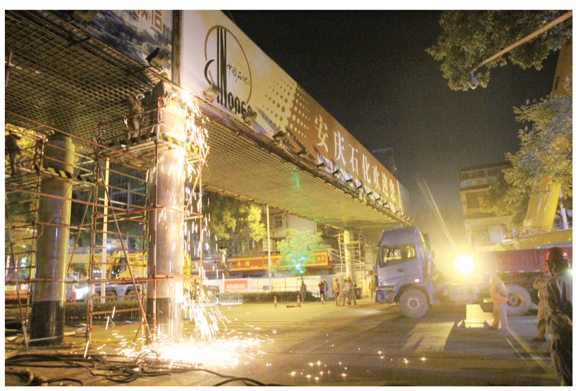
11月1日晚上11时,工人拆除集贤南路上的石化管廊带。记者 徐火炬 摄
