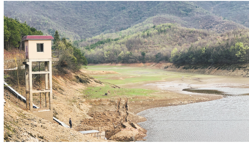
3月29日,工人在抢修涵洞。怀宁县清河乡金山水库涵洞由于泄洪口塌方造成涵洞损坏,该乡利用当前枯水期,对该涵洞进行清淤重建,确保下游一千余亩农田正常灌溉。
