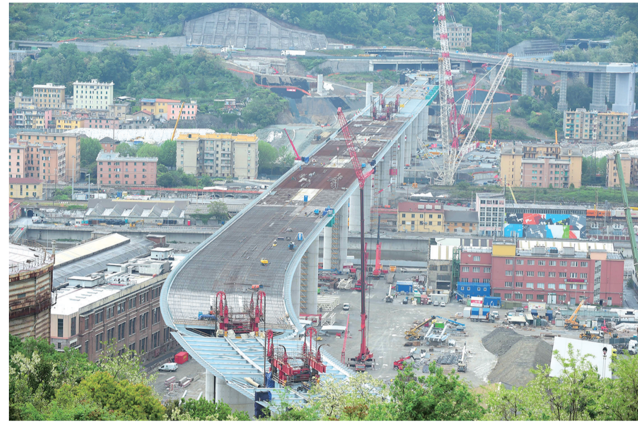
4月28日,在意大利热那亚,新公路桥正在建设中。 热那亚公路桥建于上世纪60年代,是热那亚工业港口连接欧洲的重要基础设施。该桥梁于2018年8月14日发生垮塌事故,造成43人死亡。目前,意大利热那亚新的公路桥正在建设中。 新华社发(阿尔贝托摄)
