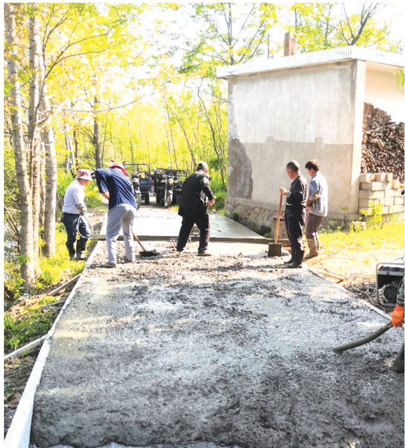
5月8日,施工队在怀宁县高河镇独枫村铺设水泥混凝土,现场一片忙碌景象。为进一步改善人居环境,助推精准扶贫,高河镇着力加强农村基础设施建设,今年全面启动40公里“四好农村路”建设。通讯员 檀志扬 操乐祥 摄
