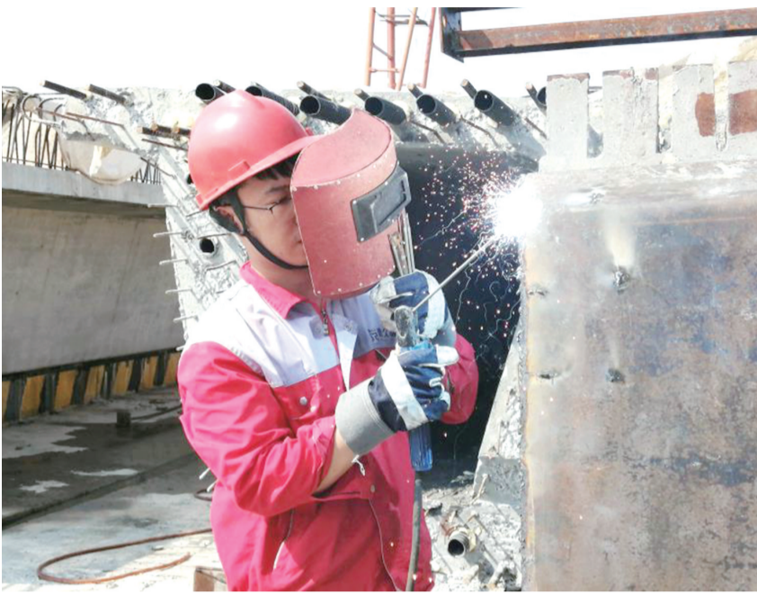
9月8日上午,项目施工人员正在进行桥梁箱梁模板堵头板固定焊接。 通讯员 吴根琴 摄
