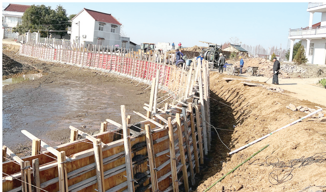
望江县赛口镇万全村拓宽村道项目施工现场。通讯员 陈娅 摄
