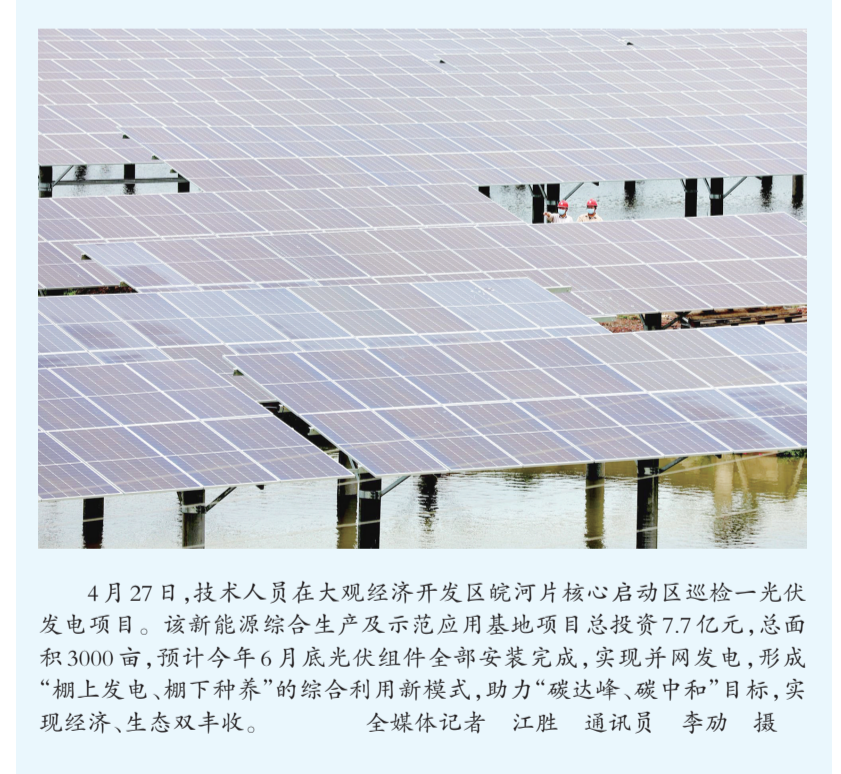
4月27日,技术人员在大观经济开发区皖河片核心区启动区巡检一光伏发电项目。该新能源综合生产及示范应用基地项目总投资7.7亿元,总面积3000亩,预计今年6月底光伏组件全部安装完成,实现并网发电,形成“棚上发电、棚下种养”的综合利用新模式,助力“碳达峰、碳中和”目标,实现经济、生态双丰收。
