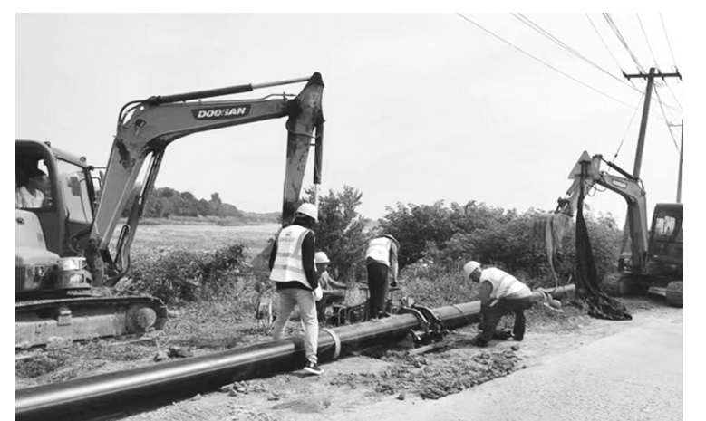
7月20日，望江县赛口镇清泉自来水厂新潭河段施工现场。针对持续高温少雨天气给自来水厂水源带来的影响，望江县快速启动应急工程，紧急建设供水管道补充水源，为群众生活用水提供保障。中铁四局望江项目部工程技术人员头顶烈日，冒着高温，对应急供水管道进行焊接组装后，利用挖掘机快速铺设。通讯员 金锋 杨姗姗 摄
