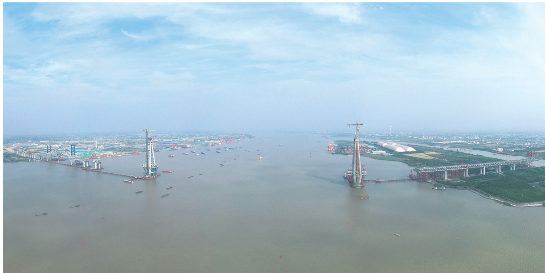
建设中的常泰长江大桥(5月21日摄，无人机照片)。常泰长江大桥连接江苏常州和泰州两市，全长10.03公里，是一座集高速公路、城际铁路和普通公路为一体的过江通道。目前，大桥建设正在有序推进中。新华社记者 季春鹏 摄
