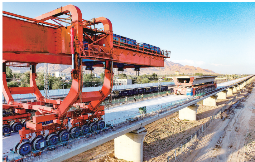
8月8日拍摄的包银高铁跨巴彦花铁路专用线特大桥箱梁架设施工现场(无人机照片)。当日,该铁路专用线特大桥箱梁架设任务完成,标志着包银高铁巴彦淖尔段首座跨铁路专用线特大桥主体工程结束。包银高铁是我国“八纵八横”高速铁路网京兰通道的重要组成部分,设计时速250公里,计划2025年建成通车。
