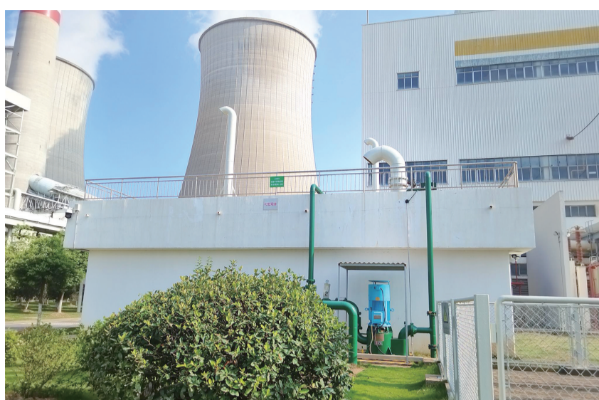
图为大电厂节水处理系统。 全媒体记者 雷琳琳 摄
