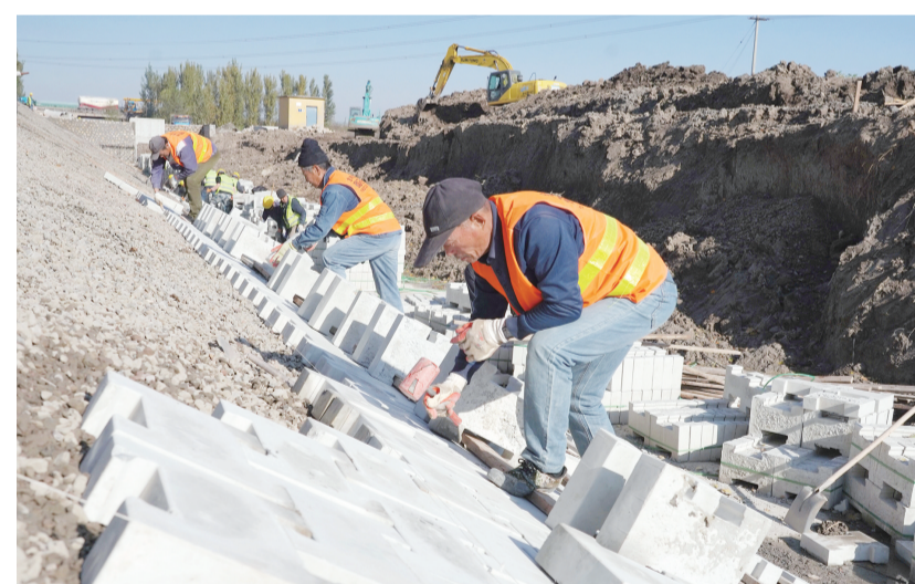
11月7日,工人在唐山市丰南区灌溉水渠护坡加固工地施工。近日,河北省唐山市丰南区抢抓枯水期,进行河道疏浚等水利设施建设工作,通过兴修和完善水利基础设施,为农业生产和防汛抗旱提供保障。新华社记者 杨世光 摄
