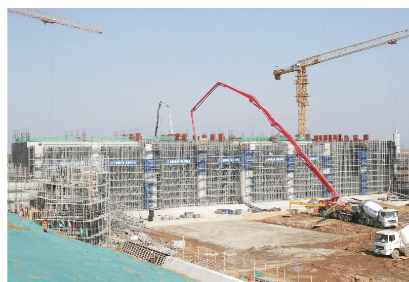
望江县杨湾节制闸施工现场,塔吊高耸,机械轰鸣,百余名建设者扎钢筋、制模,浇筑混凝土(1月25日摄)。
