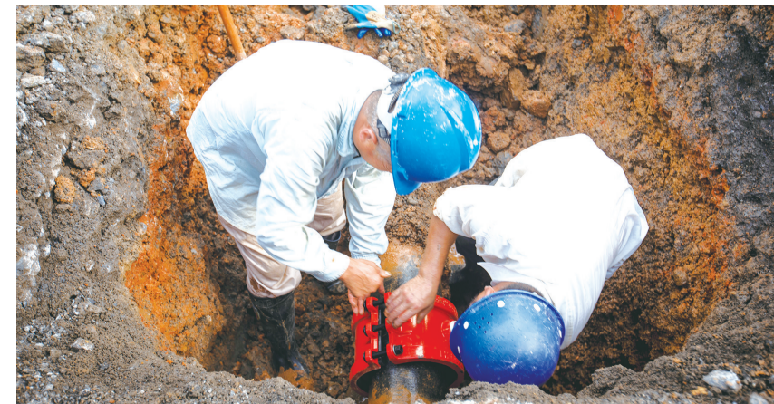
正在检修迎江区职工之家东区(胜利路北)管径200毫米管点。通讯员 殷春骏 摄
