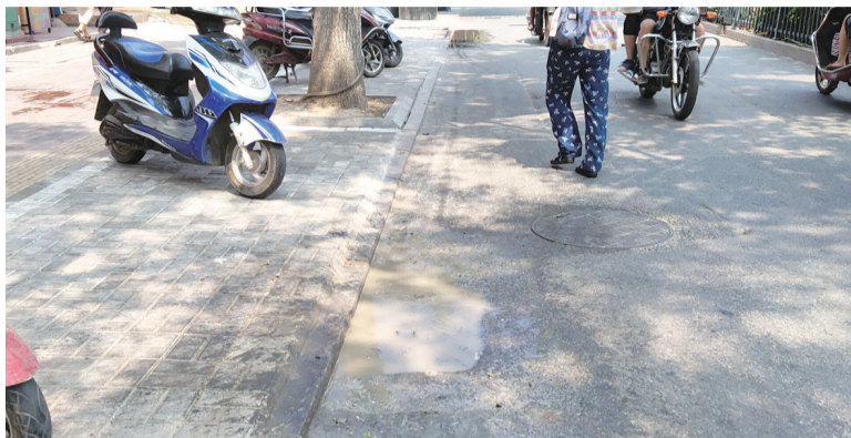
图为雨水篦堵塞漫溢
