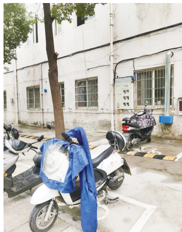
图为12月8日,机场新村小区附近一办公楼外私拉电线充电乱象。
