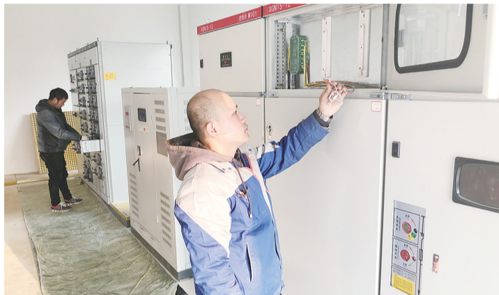
1月6日,技术人员在调试设备。怀宁县月山镇投资1500多万元,建成日供水能力达1000吨的污水处理厂,并配套市政污水管网,有效解决集镇群众生活污水处理问题,净化周边水质,保护生态环境。
