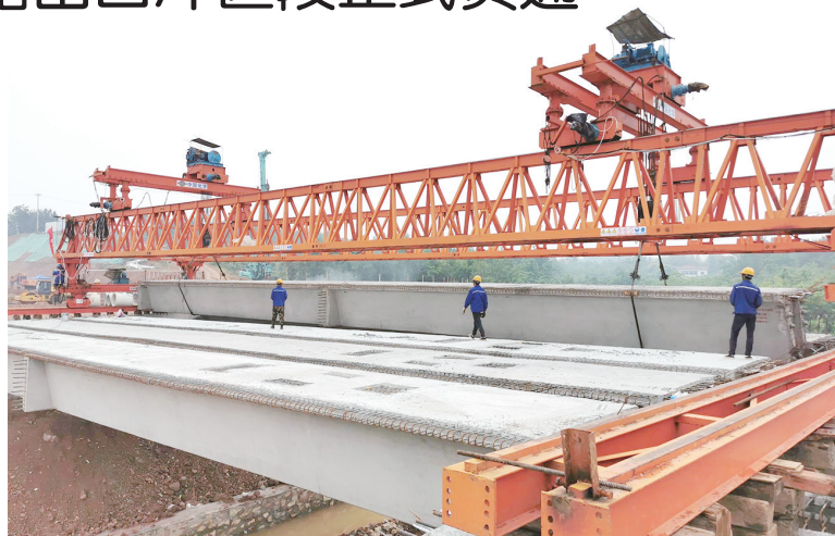
5月19日上午,施工人员正在架设头坡湖大桥右幅箱梁。全媒体记者 项珍 摄
