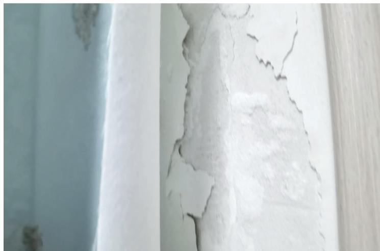
夏先生家房间墙壁的墙皮大范围鼓包、脱落。
