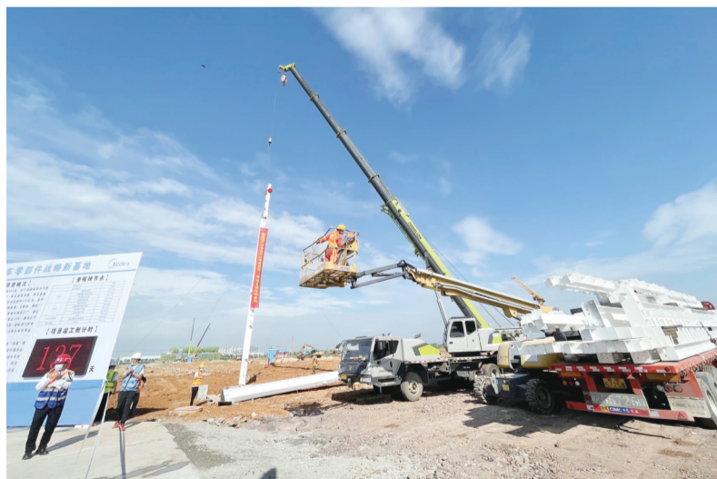
7月5日,美的新能源汽车零部件战略新基地(一期)项目钢结构首吊。
