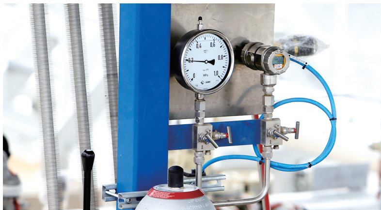
这是6月28日在罗马尼亚康斯坦察县瓦杜村拍摄的天然气处理站的设备(资料照片)。
