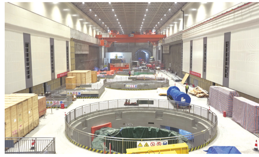
3月19日,在国网新源安徽桐城抽水蓄能电站建设现场,施工人员各司其职,全力冲刺年底首台机组安装调试目标。当前,项目整体工程已完成70%,各项主体施工稳步推进。 通讯员 徐鑫鑫 汪立 摄
