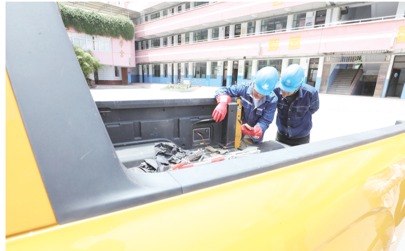
供电公司工作人员正在对应急发电车启动供电及英语听力UPS供电能力进行测试。 全媒体记者 江胜 摄
