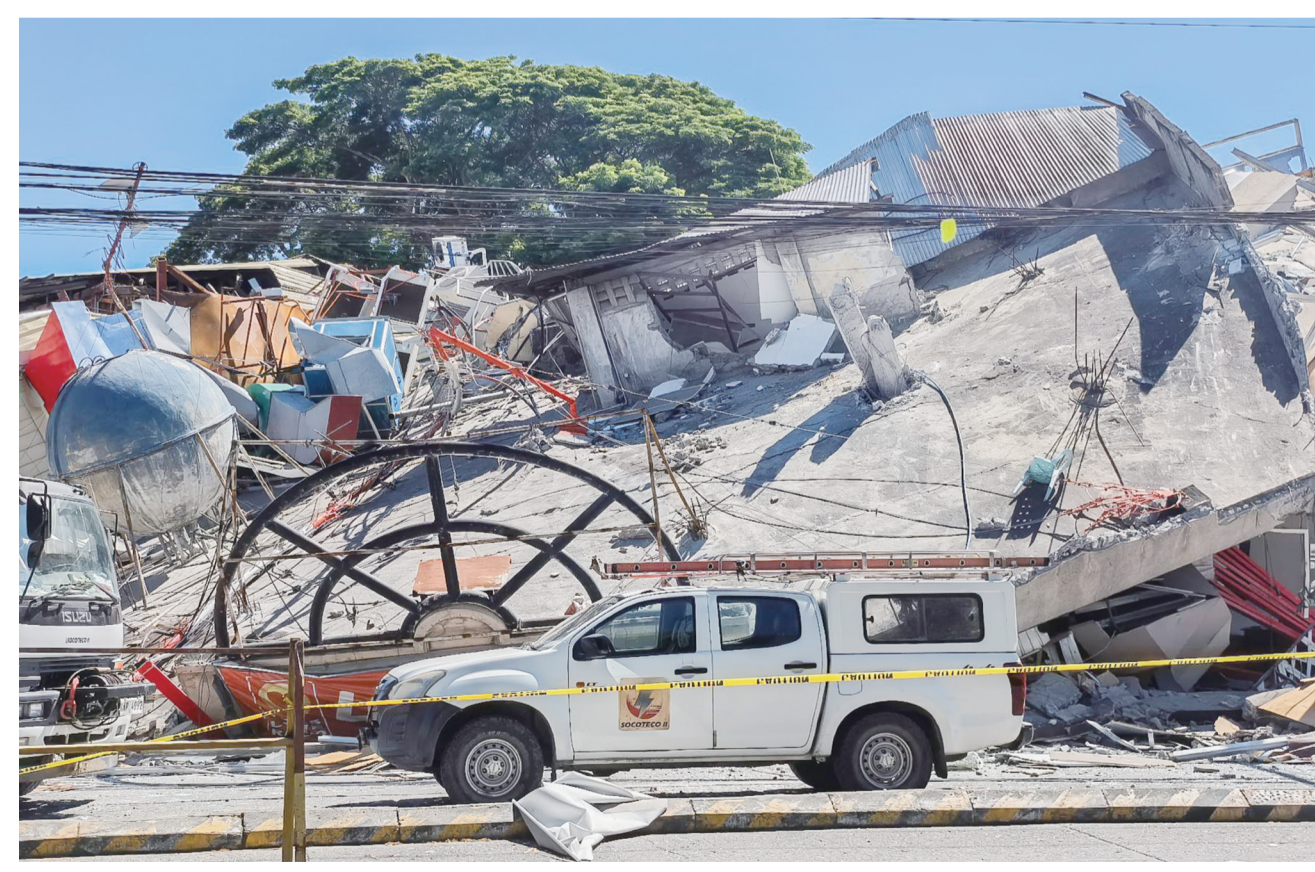
这是6月8日地震发生后在菲律宾桑托斯将军城拍摄的损毁的建筑。 新华社发
