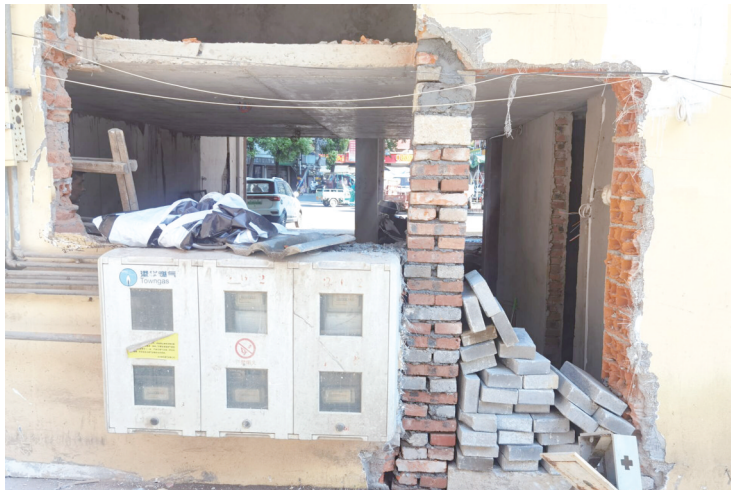
荷仙桥小区3栋沿街一家商铺私自“破墙开门”
