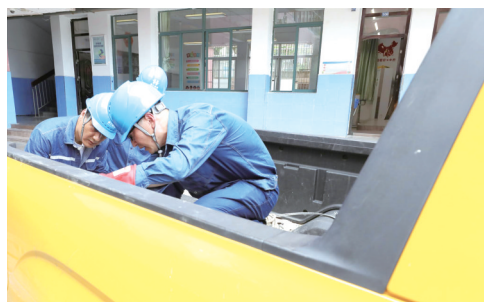
国网安庆供电公司工作人员对应急发电车启动供电进行测试。 全媒体记者 江胜 摄
