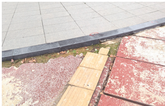
形成“断头”盲道。盲道被人行道覆盖。
